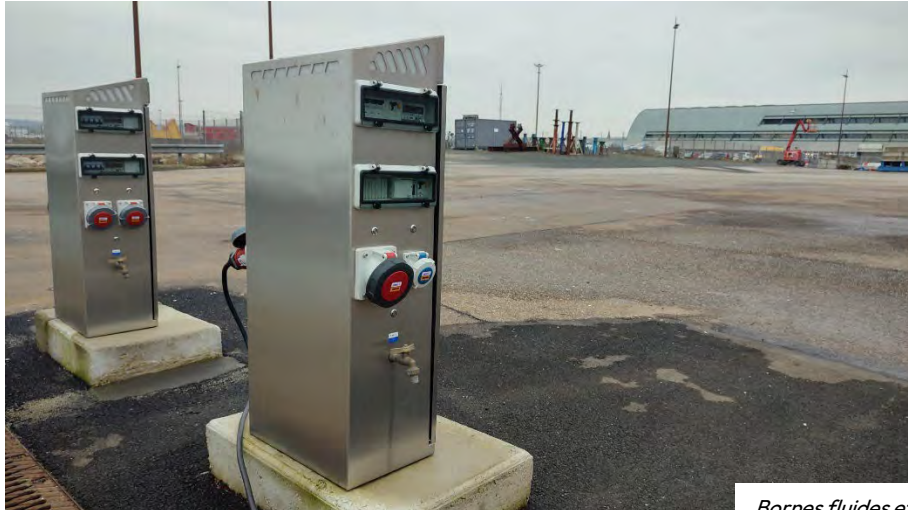
Bornes fluides et électricité @PortsdeNormandie
