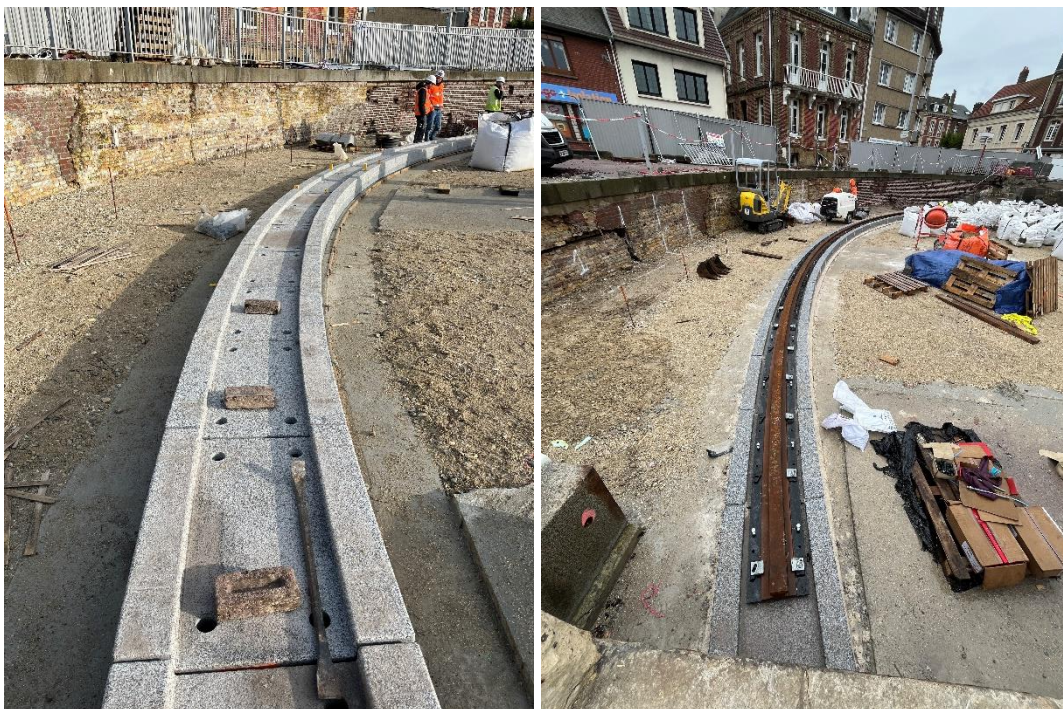
Le soubassement en granit du rail de rotation (à gauche) / Le soubassement, la platine (noire) et le rail (à droite) ©F. Thomas – Ports de Normandie
