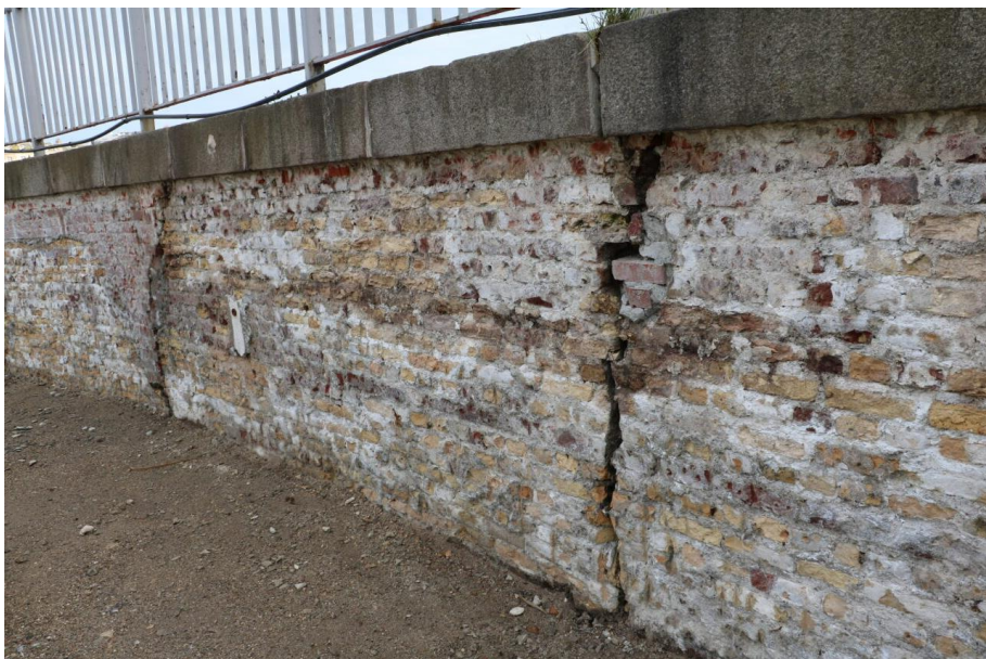
Quelques-unes des zones à reprendre sur le mur circulaire de la zone de rotation du pont ©F. Thomas – Ports de Normandie
