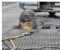
Malgré des réparations régulières, le pont devra vite être remplacé. (Photo: ANRWG Ouest-France)
